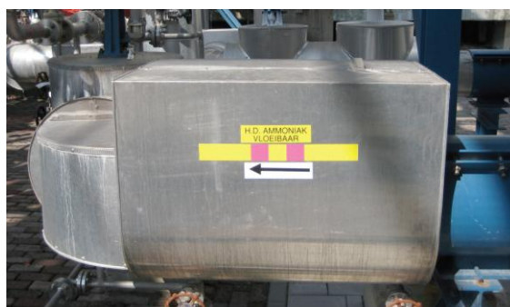
OBRÁZEK 8.8: ZNAČKA ČÁRY NA NADZEMNÍM POTRUBÍ NA AMONIAK [54].
